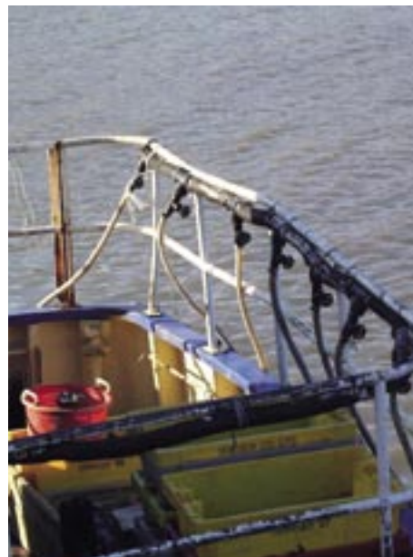
Eksempel på enkelt vanningssystem koplet til spylepumpa.
